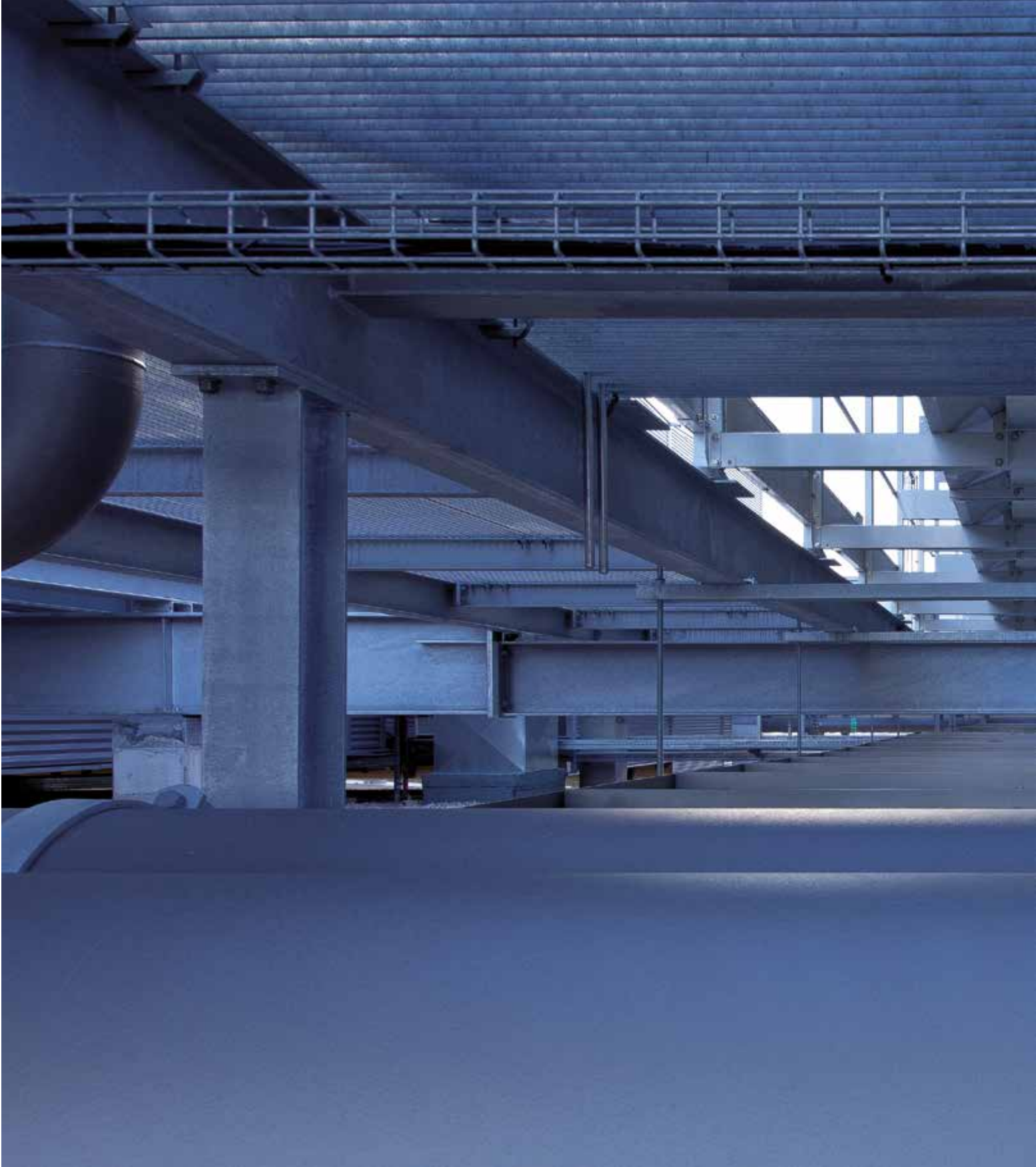
▼ Unteransicht des Technikrostes der Rückkühler
